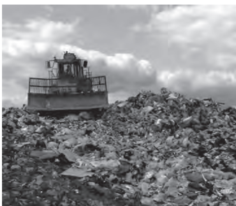
Ilustración 48: Relleno sanitario. Fuente: www.landofgraciousliving.com
