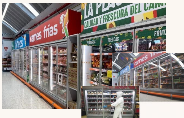
Ilustración 1. Sistemas de refrigeración usados comúnmente en supermercados del país
