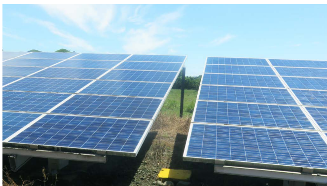
Módulos fijos en la planta fotovoltaica. Titumate.
