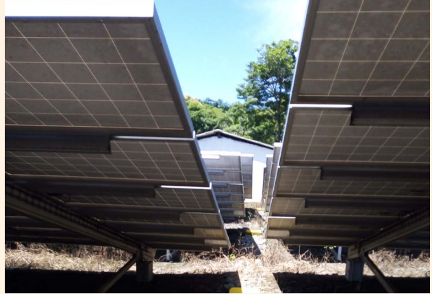
Detalle de la disposición de los paneles solares
