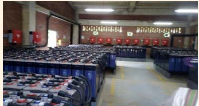
Banco de baterías
