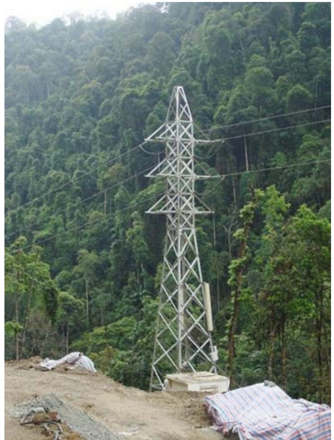
Línea de transmisión en un área sensible
