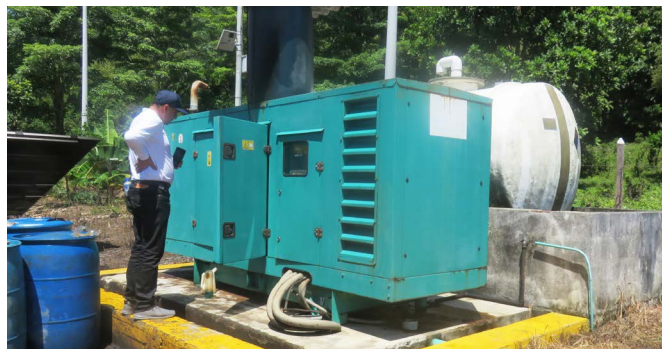
Derrame de diésel alrededor de la planta en Titumate Nótese la falta de impermeabilización del piso alrededor de la planta y la presencia de derrames directamente al suelo. (Visita de campo)
