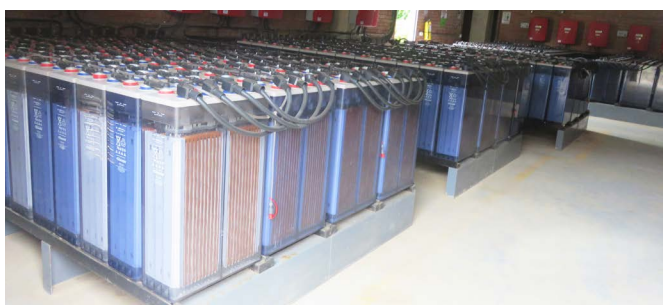
Cuarto de baterías, Isla Fuerte.
