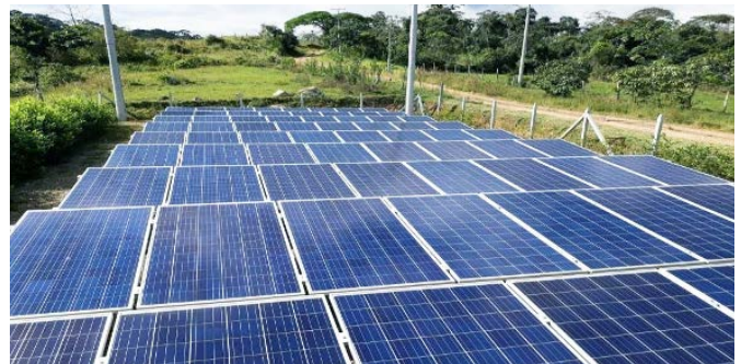
Planta solar en Paratebueno. 57 Nótese carretera destapada pasando al lado de la planta. Existe la necesidad de monitorear el polvo que se acumule sobre los paneles (Proyecto propiedad de ENEL Codensa Colombia)
