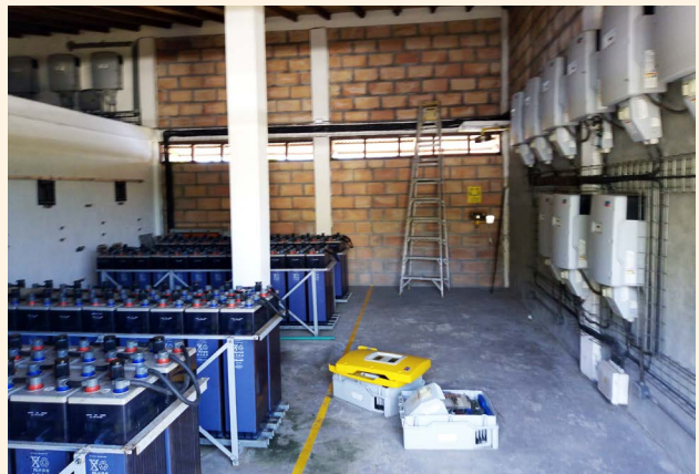
Detalle de la disposición de una de las áreas del sistema de almacenamiento, controladores e inversores
