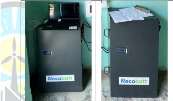
Descripción: Dentro de estos se encuentran las baterías e inversor instalados.
